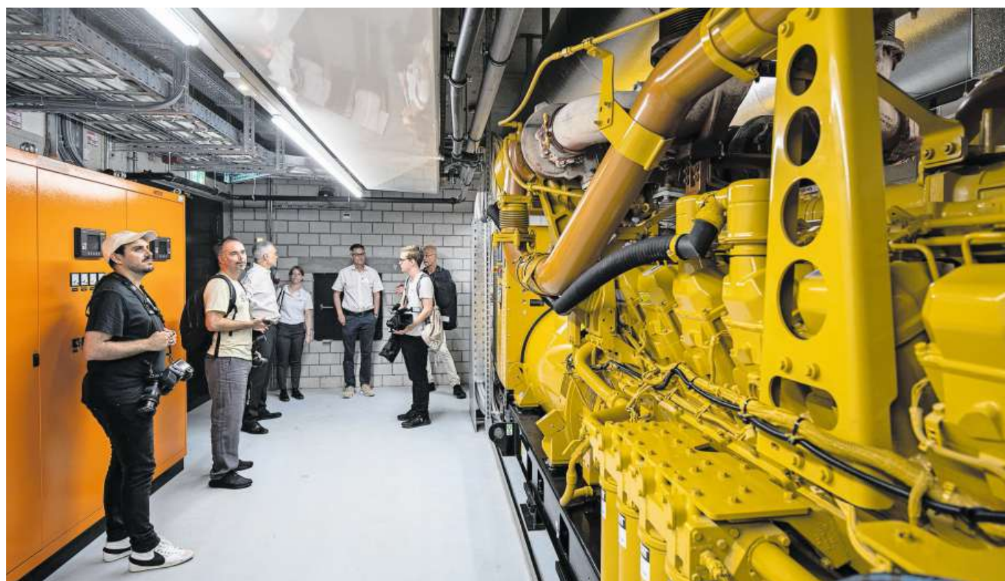
Der Notfall-Dieselegenerator im Warteggstollen.
