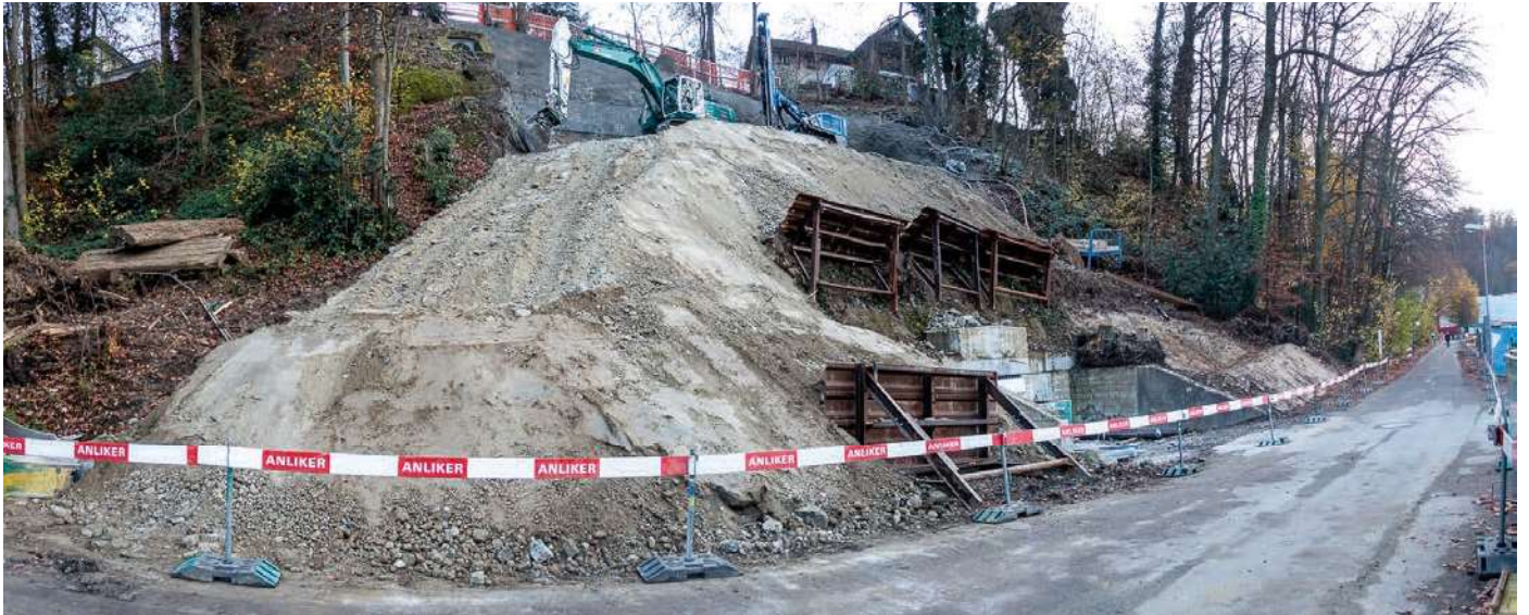
Die Arbeiten am Wartegg-Stollen sind in vollem Gang. Anfang Dezember präsentierte sich der Hügel kahl. Schon bald sollen hier wieder Bäume und Sträucher wachsen.
